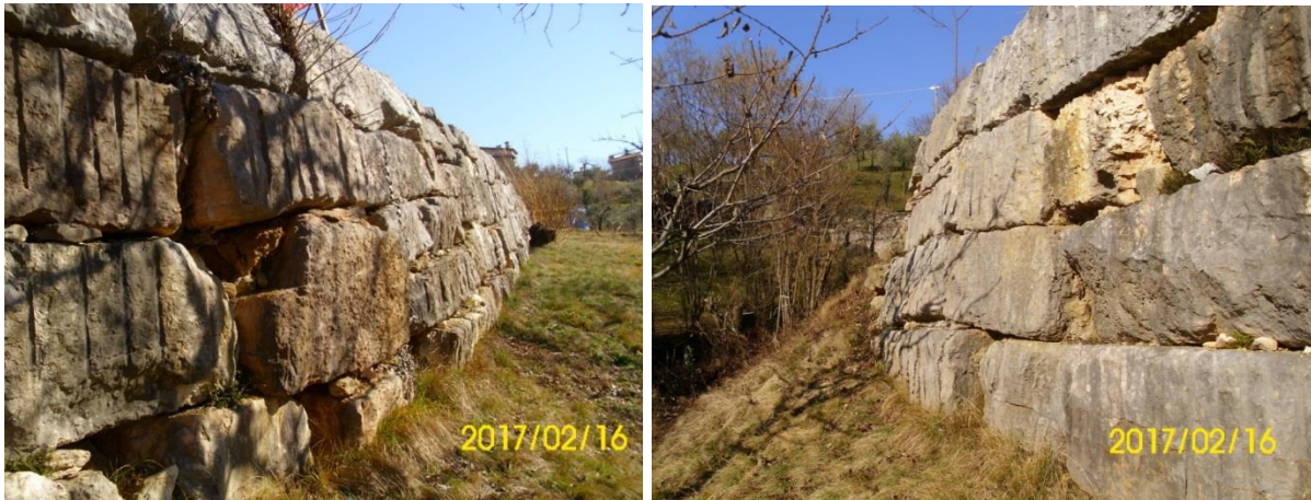
Figura 17 – Particolare paramento di valle in massi soggetto a cedimento
