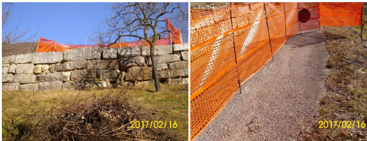
Figura 18 – Da sinistra verso destra, panoramica verso monte muro in massi e ciglio stradale in cedimento
