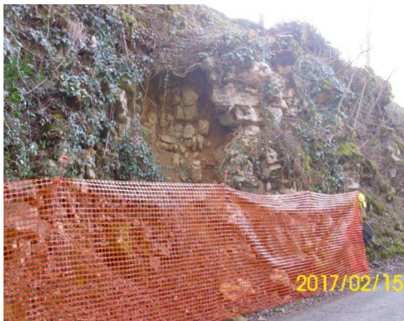
Figura 24 – Scarpata di monte in dissesto
